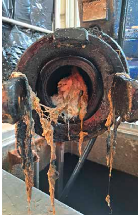
Das darf nicht sein! Haupt-pumpwerk
